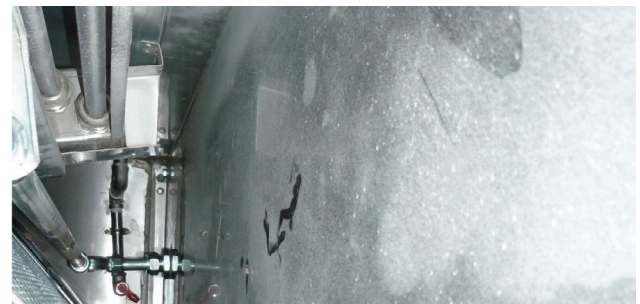
Zicht in een afzuigplenum uitgerust met UV-C-lampen na enkele weken gebruik
