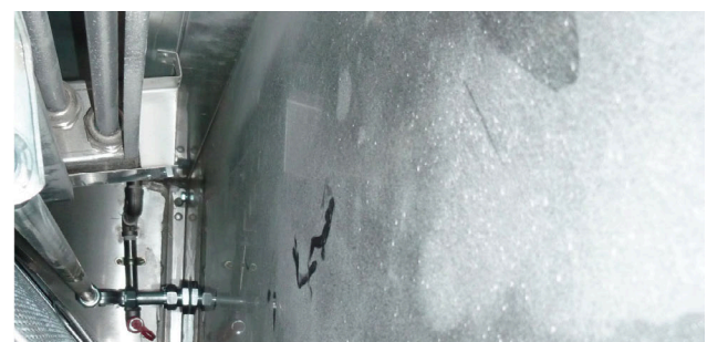
Zicht in een afvoerplenum uitgerust met UV-C lampen na enkele weken gebruik
