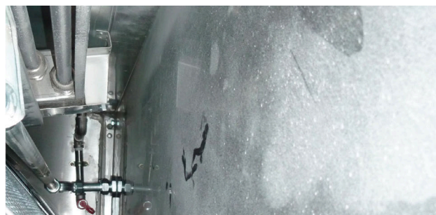
Binnenkant van een afvoerplenum uitgerust met UV-C lampen na enkele weken gebruik
