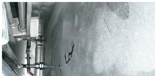
Zicht in een afzuigplenum voorzien van UV-C lampen na enkele weken gebruik
