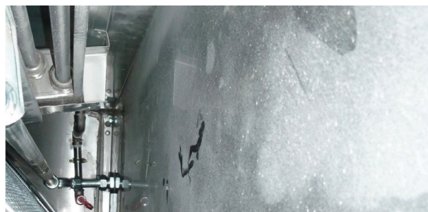
Zicht in een afzuigplenum uitgerust met UV-C-lampen na enkele weken gebruik
